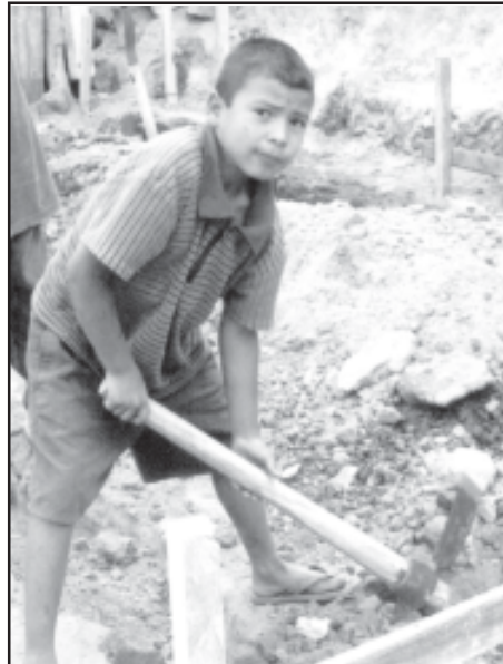
En El Mirador, hasta los niños trabajan en la reconstrucción de sus casas.
