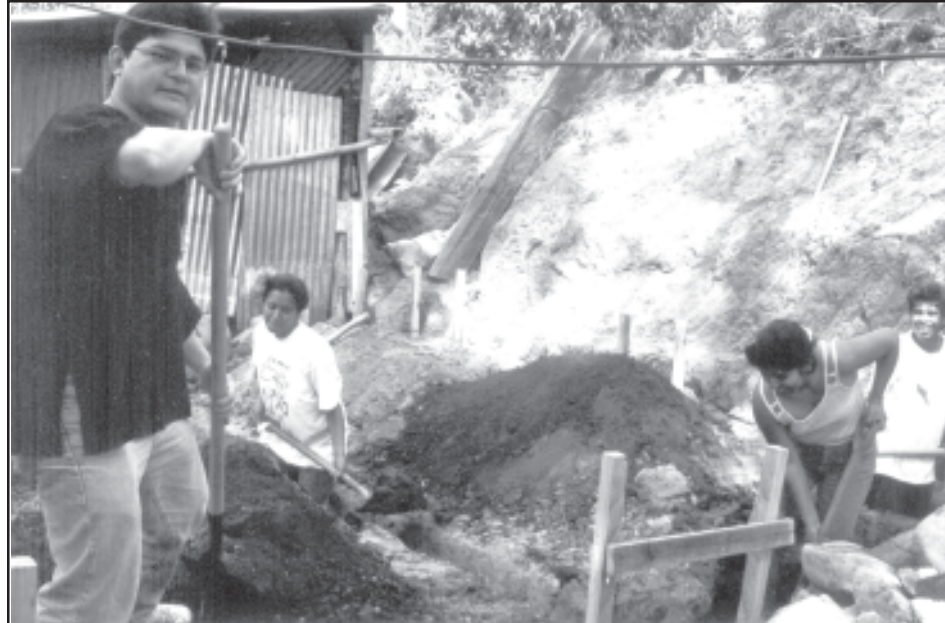
Lindolfo Carballo ayudando a una de las familias a preparar los cimientos de una de las 17 viviendas que tienen que reconstruir.
