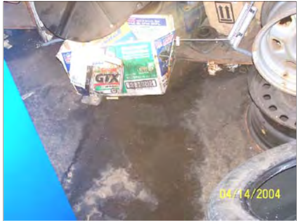
El piso del garaje municipal donde los empleados de la ciudad trabajan, mojado de la lluvia que penetra por el techo.
