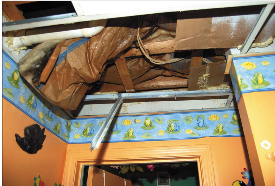
“Las lozas del techo del baño no solamente fueron removidas sino todas destruidas”, dijo Santiago.
