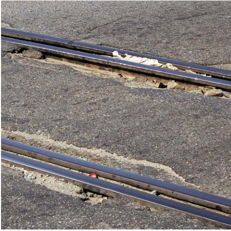
El Crucero de la Calle Haverhill entre las calles Water y Morton necesita ser reparado. Aparentemente, el concejal de este distrito utiliza otra vía para ir a su casa.
