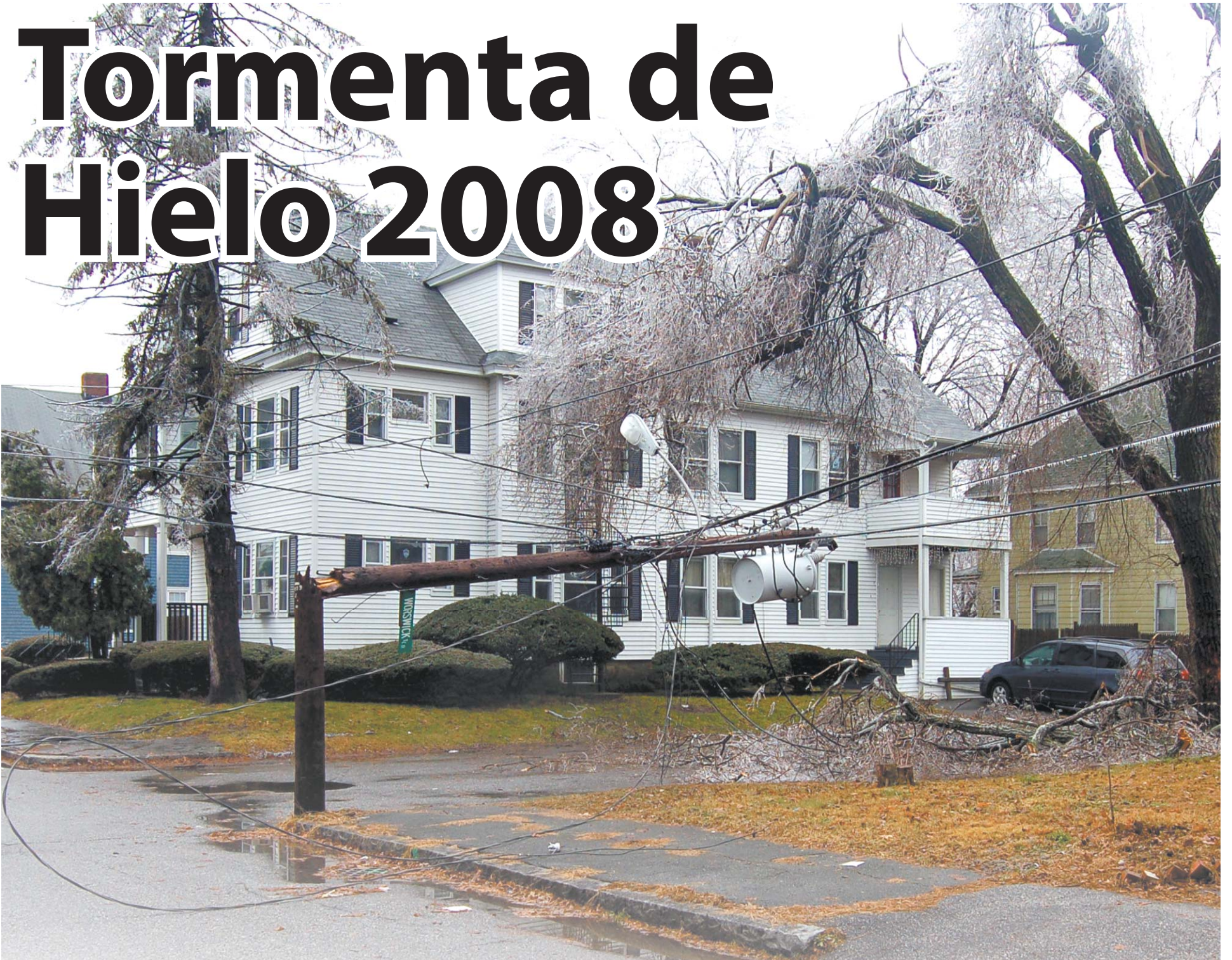
Poste eléctrico en la esquina de las calles Royal y Worswick Ter. se partió, arrastrando consigo todo el tendido eléctrico. PÁGINA 6
