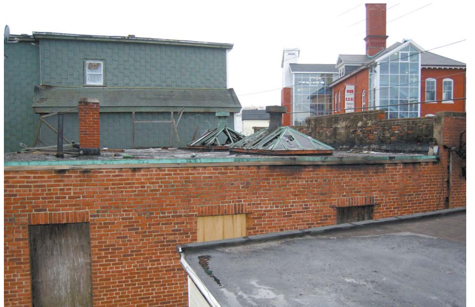
Estado en que ha quedado el techo de cristales después del fuego.
