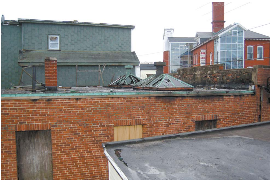
Estado en que ha quedado el techo de cristales después del fuego.
