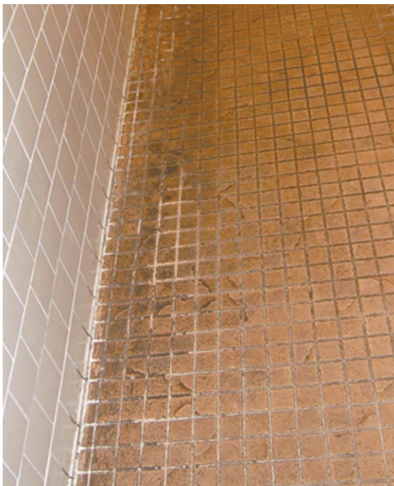
Foto del piso del baño de los hombres en el primer nivel del ayuntamiento de Lawrence. Esta foto fue tomada por indicación del Alcalde-Electo, Representante William Lantigua.
