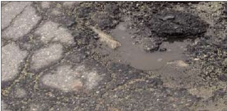
Arriba es un bache fuera del Ayuntamiento / Above is a pothole outside of City Hall.
