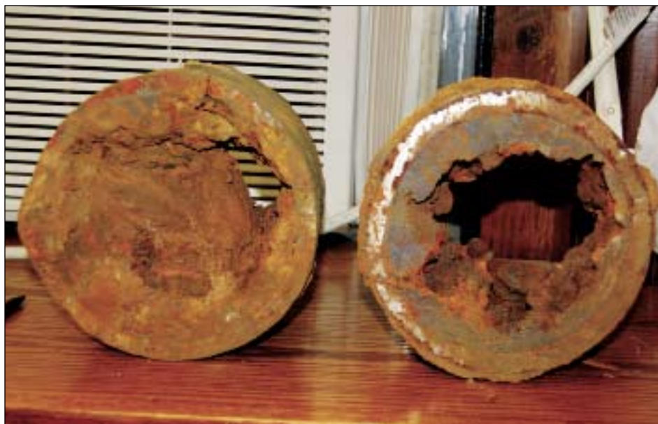
Tuberías tupidas como estas son muy comunes en la ciudad.
